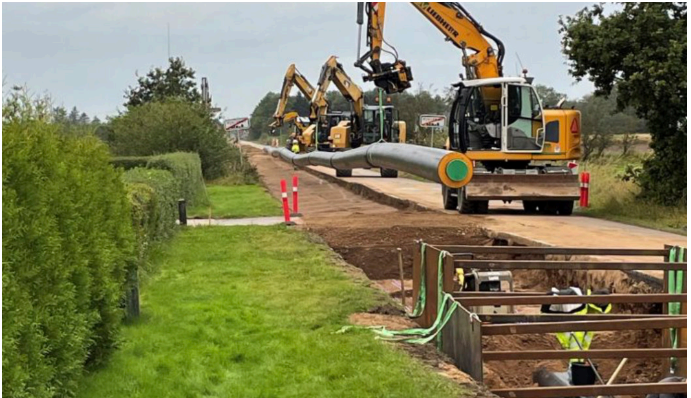
Nørgaard Anlæg ApS utför etablering av avlopps- och fjärrvärmerör i Hjortkær, Danmark.
